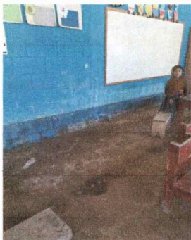
Foto 5: El piso de torta de cemento esta muy deteriorado
